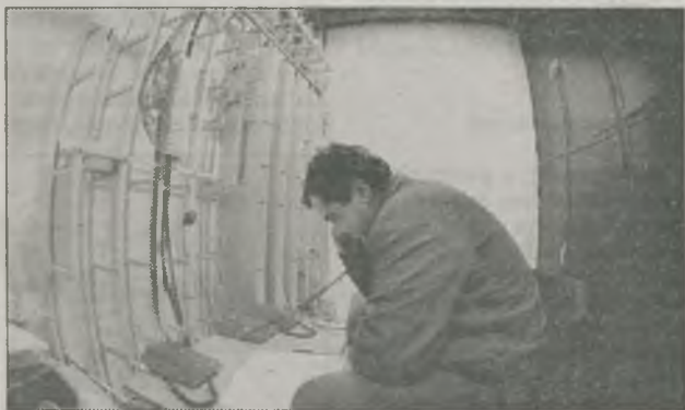
Talán ez volt az utolsó ellenőrzés a központ üzembehelyezése előtt Fotó: F. Szilágyi Imre
